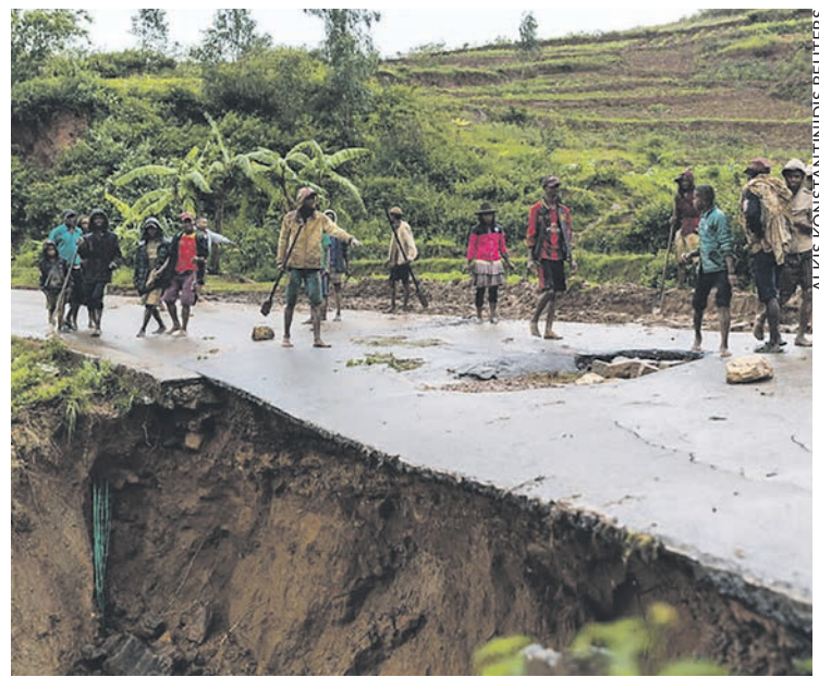
Madagascar, glissement de terrain après le passage du cyclone.
