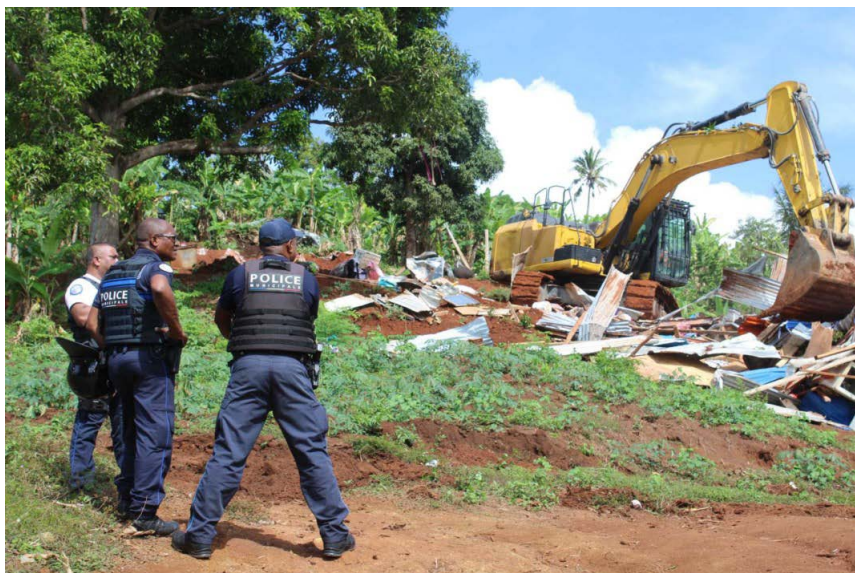
Destruction d'habitations de fortune lors de l'opération Wuambushu, en mai 2023.
