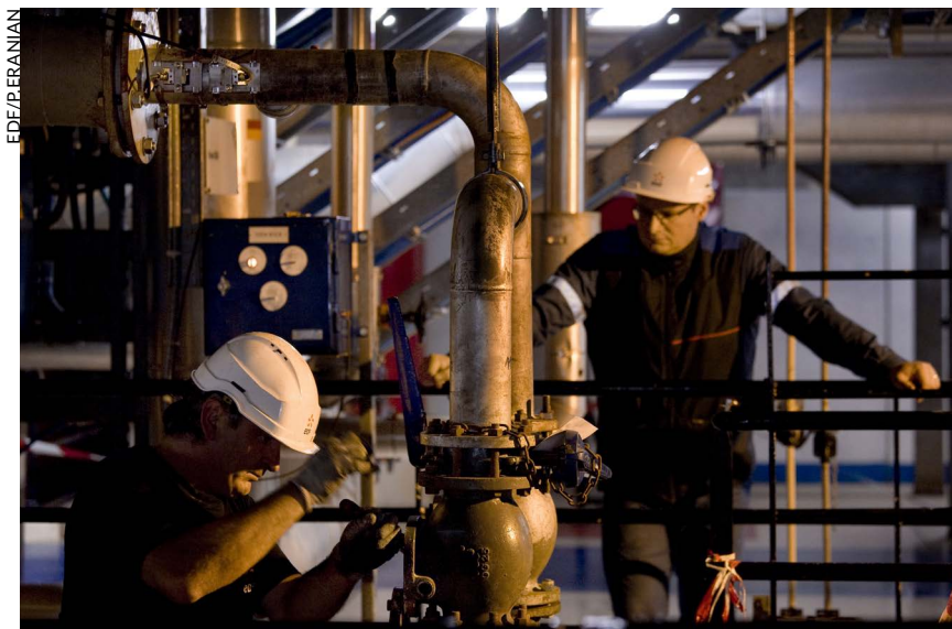
Intervention sur une fuite dans la centrale de Penly, sur la côte de la Manche, près de Dieppe.
